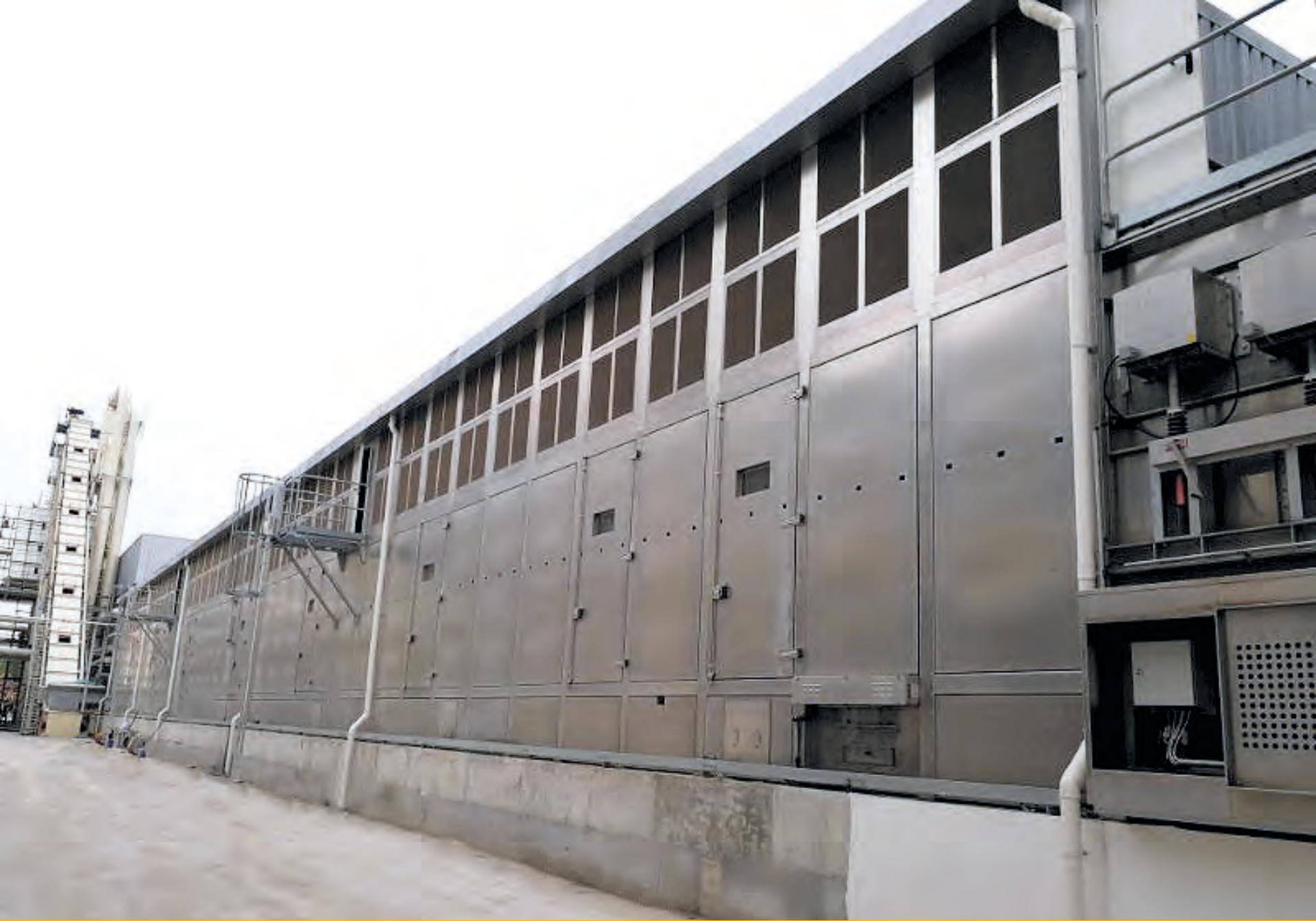
项目地：东盾木业，中国 | 型号：BTU 1/6200-61.5-8/3 | 安装年份：2019 干燥物料：木屑、木片 | 出料能力：约25.5吨/小时 | 降水区间：80% - 2%含水率
