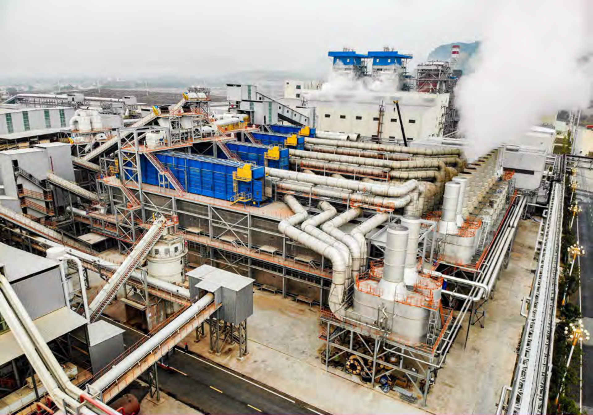
项目地：鲁丽木业，中国江西 | 型号：4x BTU 2/6200-61.5-14/6 | 安装年份：2023 干燥物料：OSB板/LSB板 | 出料能力：约160.0吨/小时 | 降水区间：100% - 2%含水率
