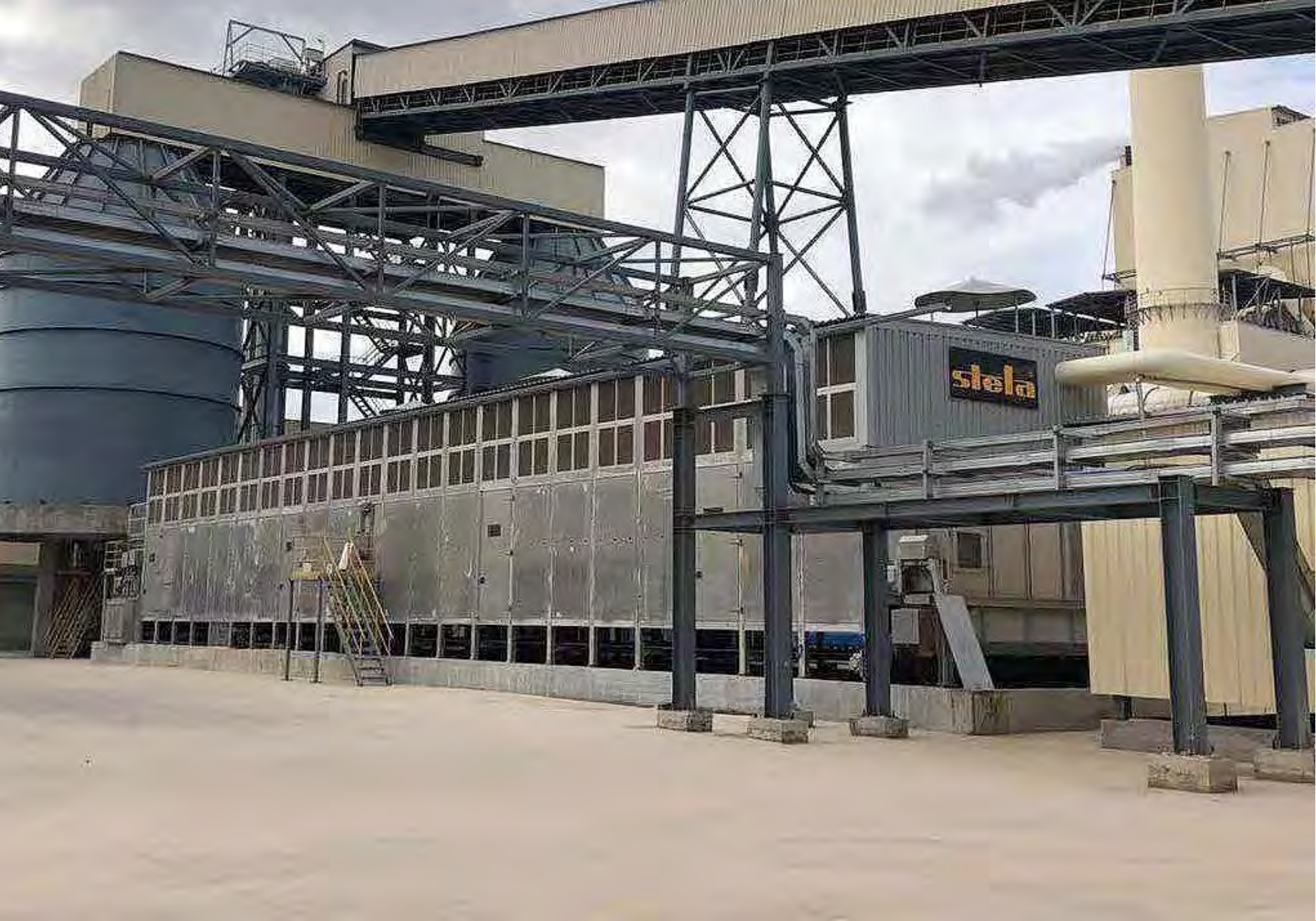
项目地：太阳纸业，老挝 | 型号：2x BT 1/6200-33 | 安装年份：2019 干燥物料：纸污泥、木屑树皮和浆渣 | 出料能力：约2x 40.2吨/小时 | 降水区间：55% - 30%湿度
